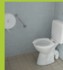
WC inadaptés : la barre d'appui est mal positionnée, la hauteur de la cuvette est insuffisante.
