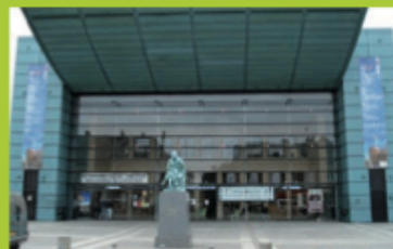
Une façade vitrée qui fait obstacle à l'entrée pour les handicapés visuels.
