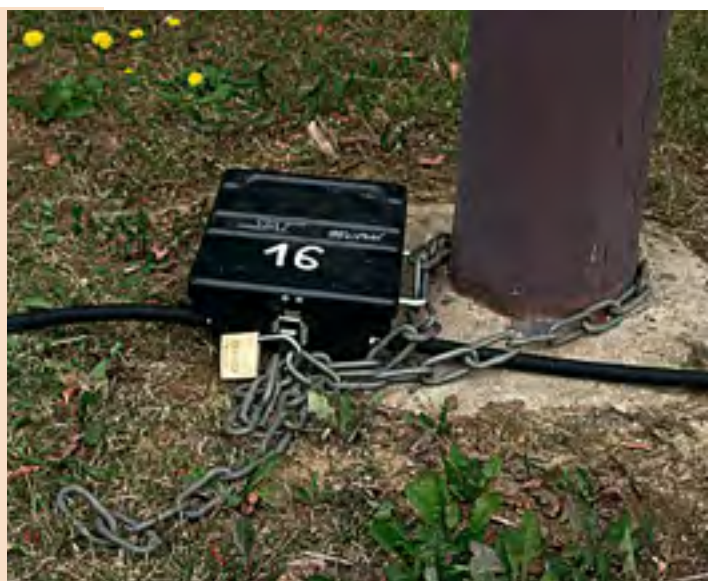
Photo 11 : compteur fixé avec une chaîne.
